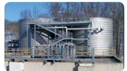
Dairy Plant, USA AnoxKaldnes™ MBBR
